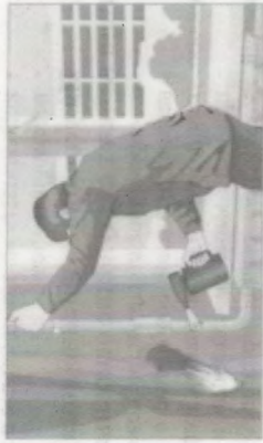
Нарушение правил проведения сварочных работ
