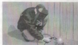
Нарушение правил проведения сварочных работ
